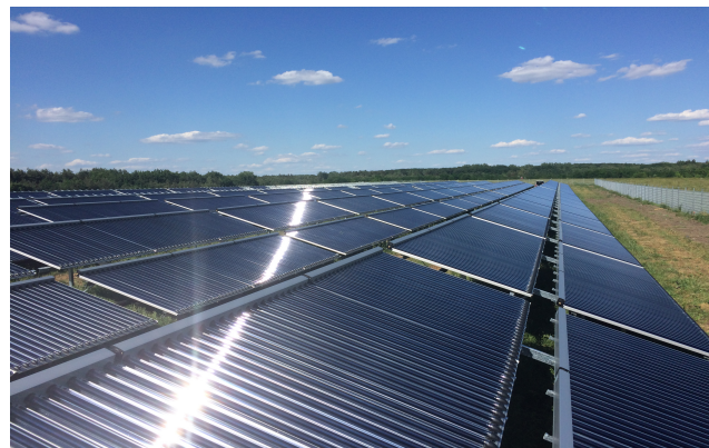
Abb. 2: Kollektorfeld für Fernwärme
