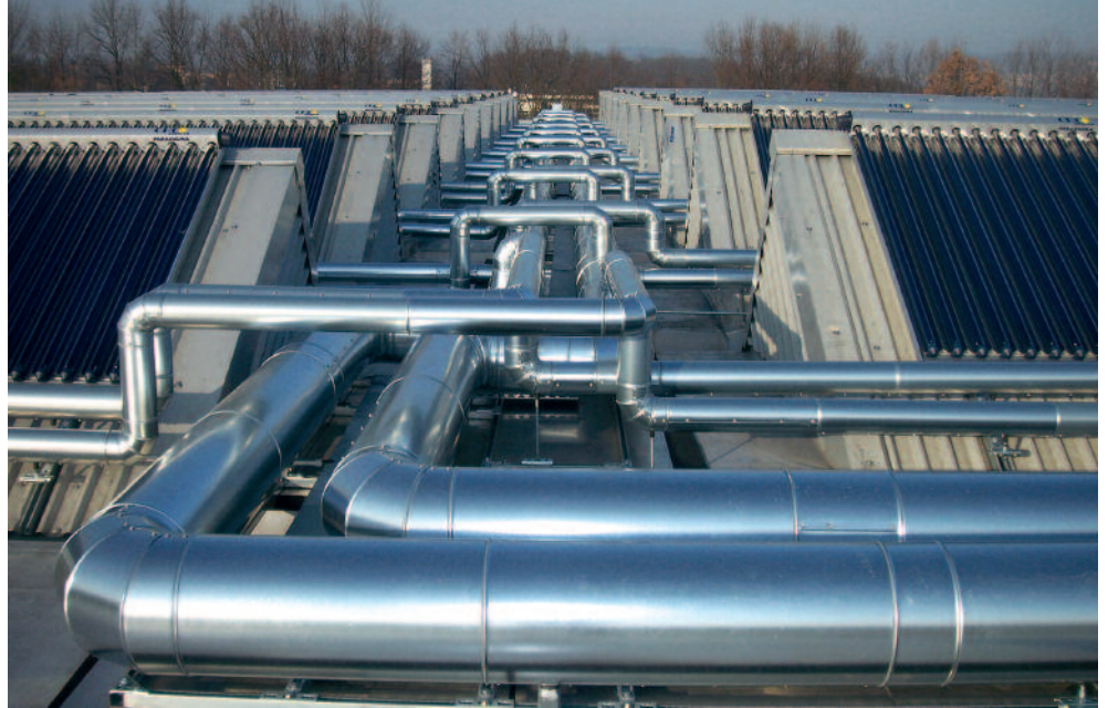
Bild 7 • Versorgung von Büro- und Produktionsgebäuden (FESTO) in Esslingen mit ca. 550 MWh/a bei 85 °C (Kühlung) bzw. 55 °C (Heizung) aus 1338 m 2 CPC-VRK und 16 m 3 Speicher seit 2006
