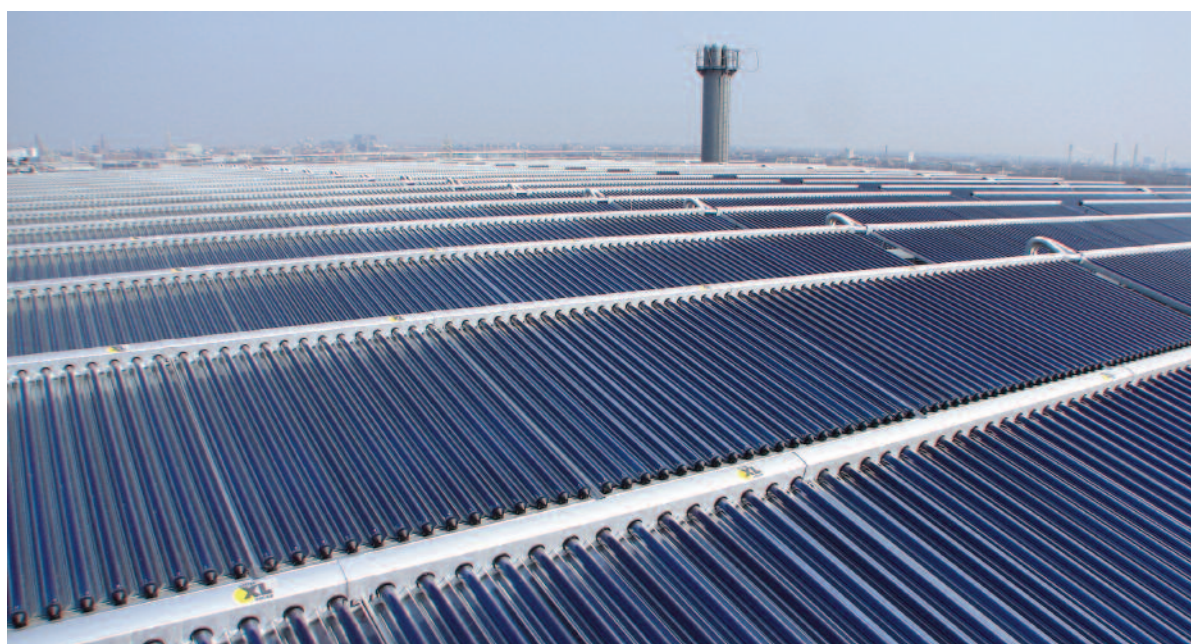
Bild 6 • Zentrale Einspeisung von ca. 550 MWh/a bei 70-95 °C vom Energiebunker ins Fernwärmenetz Wilhelmsburg mit 1348 m 2 Plasma CPC-VRK und 2000 m 3 Speicher, ein Projekt der IBA Hamburg 2013
