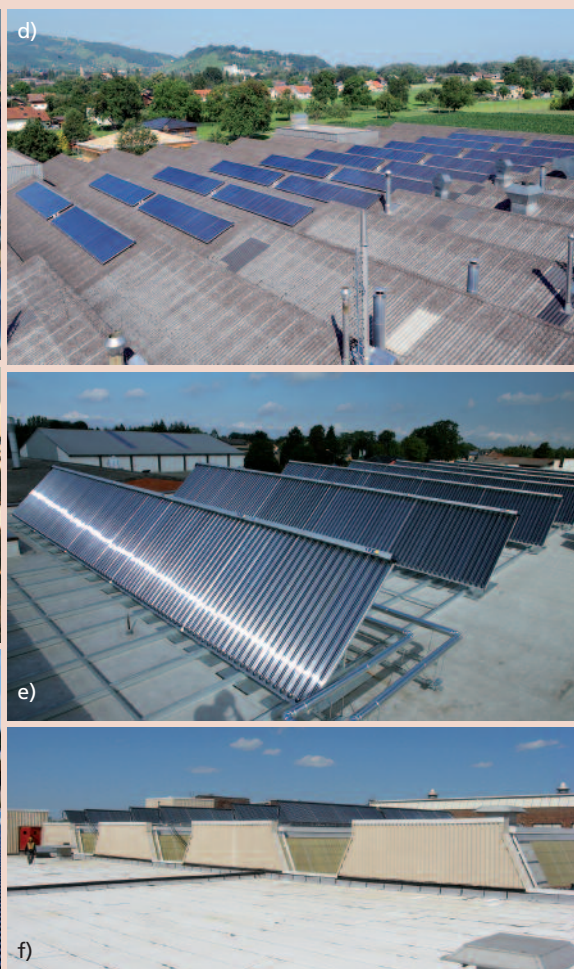
Bild 8 • Beispielanlagen für Fernwärme, Kühlung und Prozesswärme.
