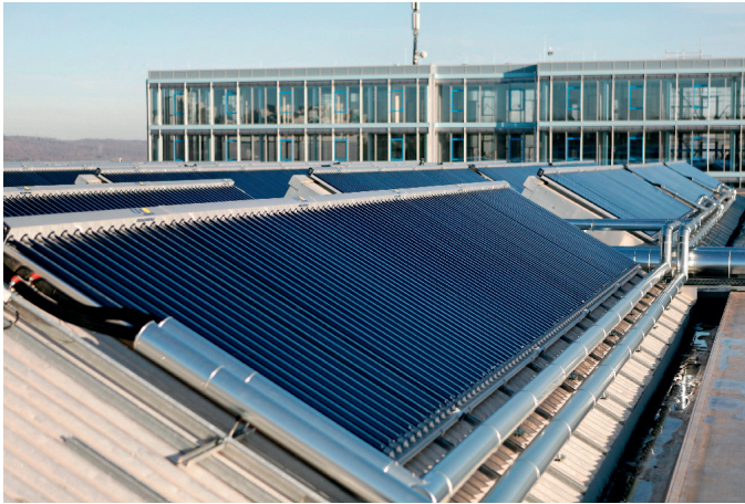
Bild 1b: Vakuumröhren-Kollektorfeld auf dem Sheddach einer Fabrikhalle
